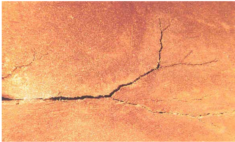
Figura 2.17 – Cricca di tensocorrosione.
